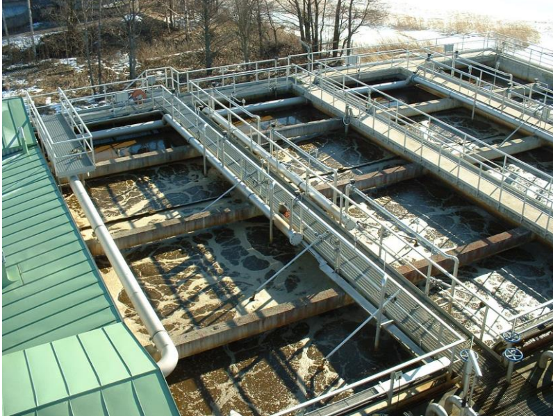
Skeppsholmenin puhdistamon ilmastointialtaat
